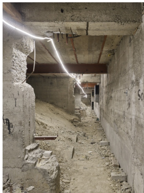
Hinter dem Haus entsteht Raum für die Technik.
